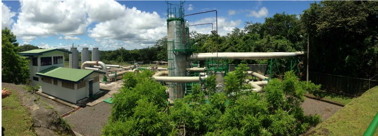
Station de séparation des phases liquide et vapeur du fluide géothermal extrait
